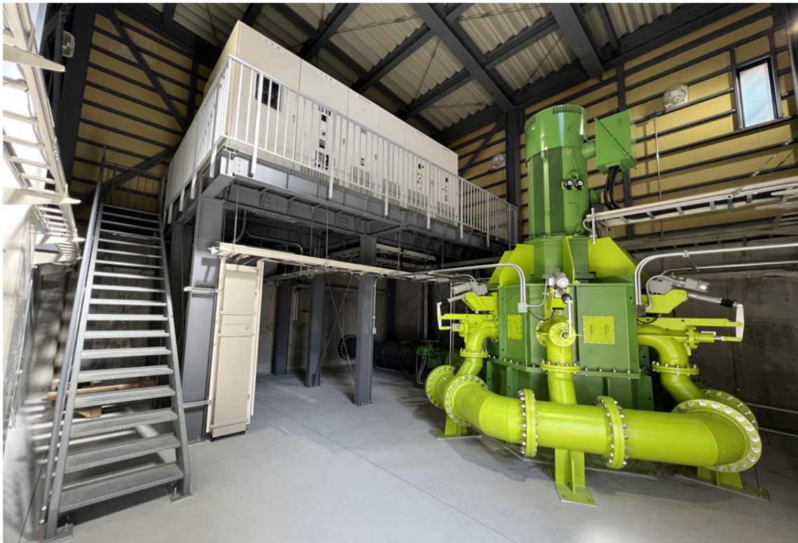
〈発電所内の様子〉
